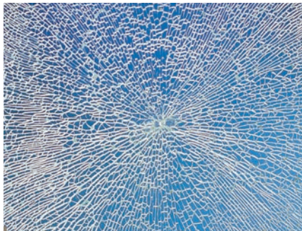
強化ガラスの破損状況
