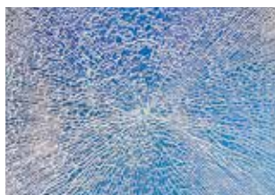
強化ガラスの破損状況
