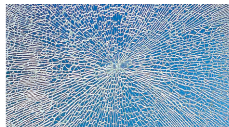
タフライト(6ミリ) 破損すると破片が細かい粒状になり、脱落の可能性があります。
