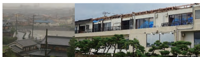
木造部分の屋根とバルコニーの被害状況(南房総市内) [国立研究開発法人建築研究所ホームページより転載]
