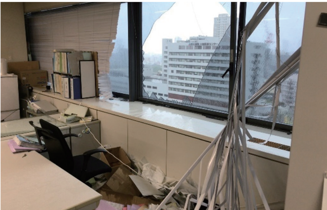
台風により破損した窓ガラス(大阪市内庁舎)
